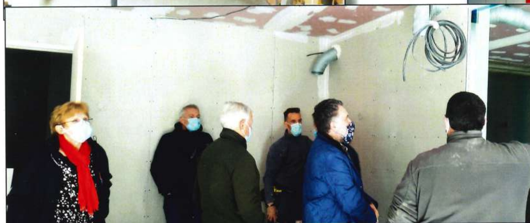
Toutes les semaines : visite de chantier avec l'architecte Mr Hamelot, le boulanger Nicolas Lattay, les artisans, M me Le Maire et Paul Crépin chargé du suivi des travaux
